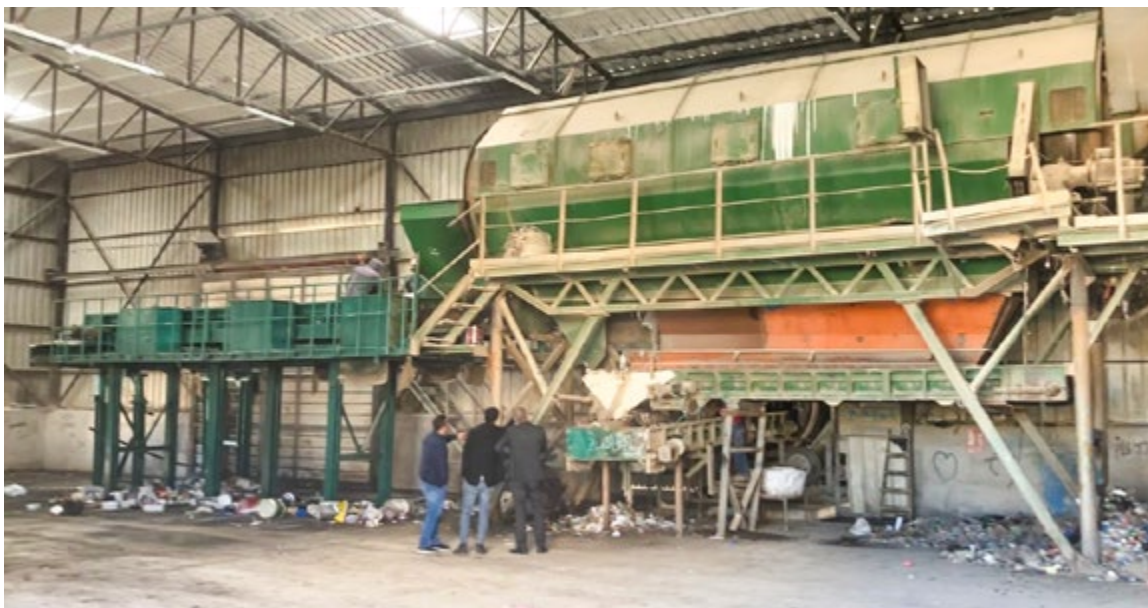
الشكل ٣,١٦: منشأة الفرز في مكب المنيا الصحي
